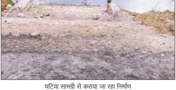
घटिया सामग्री से कराया जा रहा निर्माण
