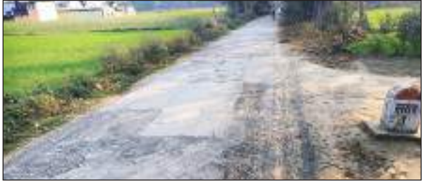
लक्ष्मणगढ़ गांव में क्षतिग्रस्त सड़क व सराय रसूलपुर मठ मार्ग की क्षतिग्रस्त सड़क।
