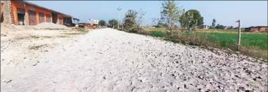
भइसर-हंसराजपुर मार्ग पर सड़क बिखरी गिट्टी।
