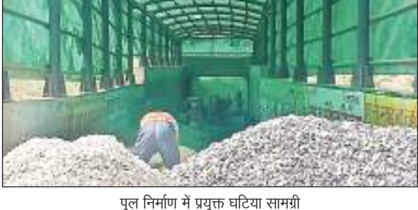
पुल निर्माण में प्रयुक्त घटिया सामग्री
