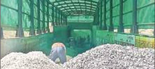
पुल निर्माण में प्रयुक्त घटिया सामग्री
