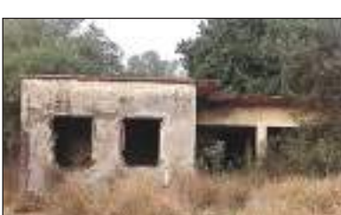
सुदनीपुर में खंडहर में तब्दील पंचायत भवन
